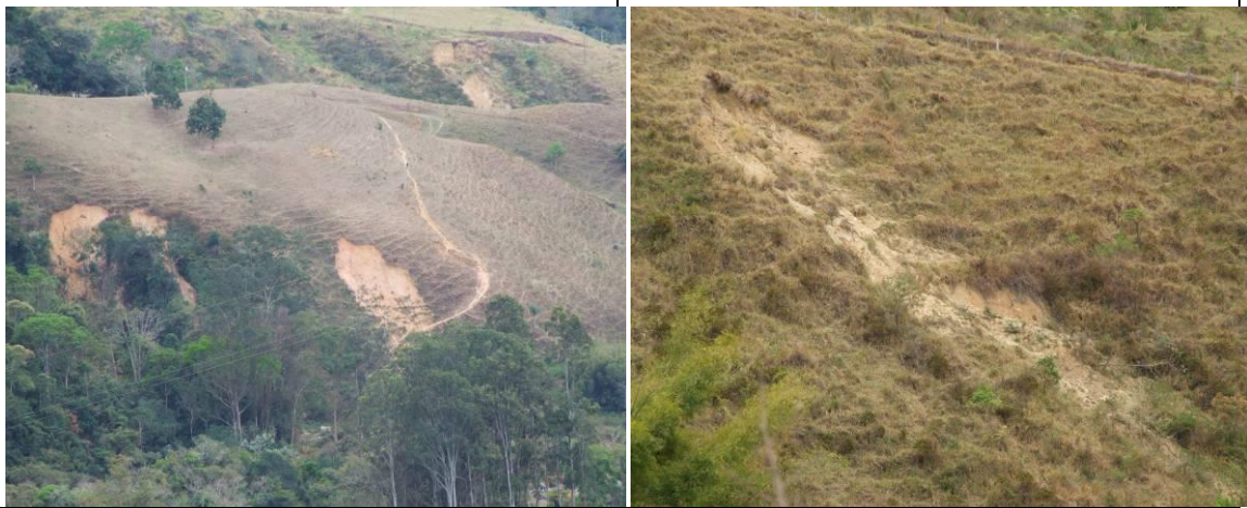
Fotos 53 e 54 - Rastejo, escorregamentos planares e processos de erosão laminar e em sulco freqüentes e de média a alta intensidade que ocorrem nos Corpos de Tálus que constituem os Terrenos Detríticos Coluviais.
